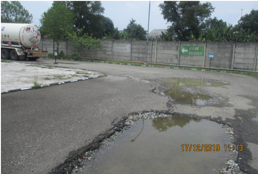
Akses jalan rusak dan bergelombang
